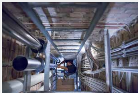
Präzisionsarbeiten in der Hauptsteigzone des Theaters. Hier verlaufen alle technischen Hausleitungen wie Strom, Wasser und Wärme.
